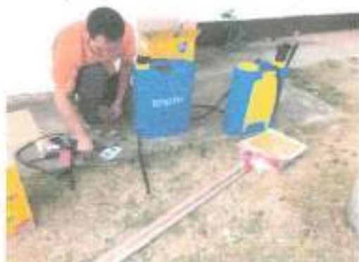
๓๓.จัดวัสดุเครื่องดับเพลิง
